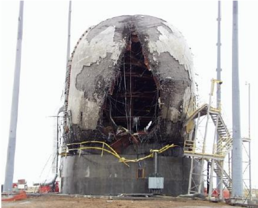
7. ábra. A nyomás által felhasított konténment [26].
